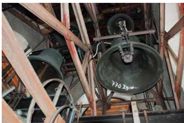
Der sanierungsbedürftige Glockenstuhl Fotos: Helmuth Plattner
