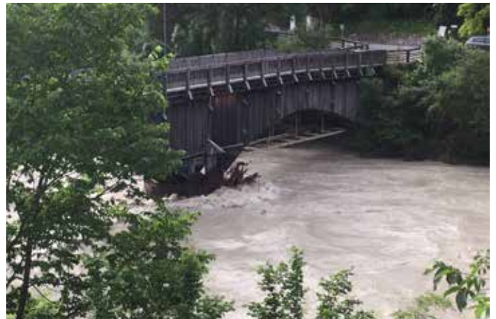
Verkläusung bei der Innbrücke im Juni 2019.
