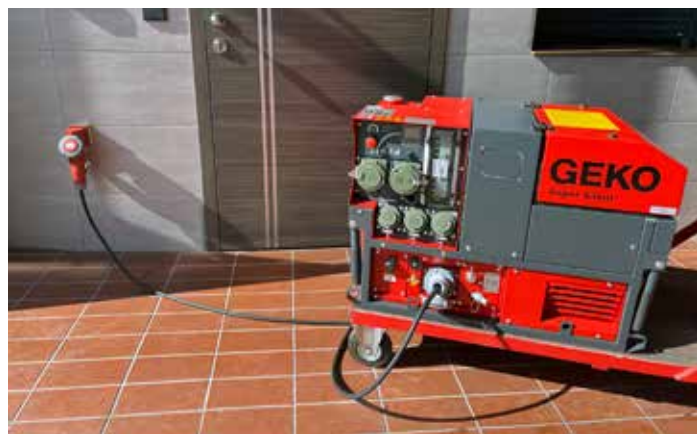
Ein Stromerzeuger zur Notstromversorgung bei einem Blackout.
