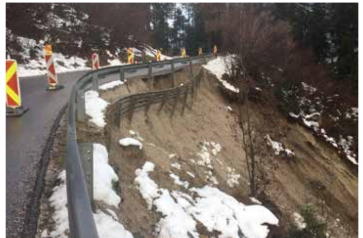
Hangrutsch über eine Länge von ca. 40 Metern.
