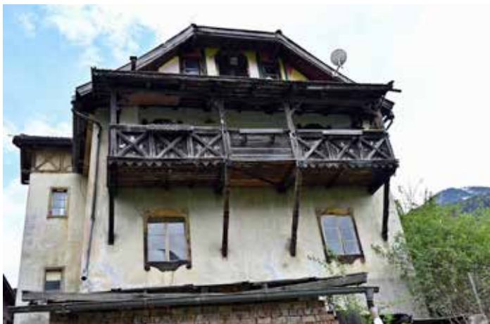
Das Bock-Haus war sehr baufällig und musste abgerissen werden.
