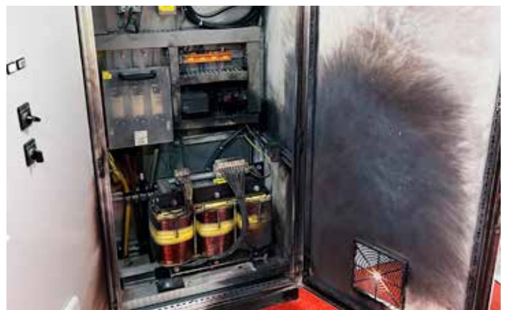
Der Blitzeinschlag verursachte große Schäden in der Elektronik. Foto: Gemeinde
