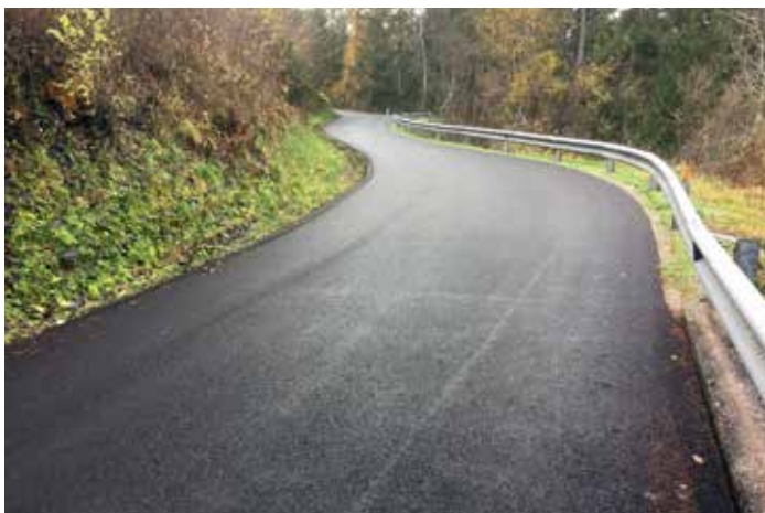
Auf Grund der großen Schäden musste die Straße Richtung Hohenegg auf einer Länge von fast einem Kilometer neu asphaltiert werden.
