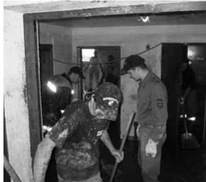
Die FF Roppen beteiligte sich tatkräftig an den Aufräumarbeiten nach dem Hochwasser im Paznauntal Foto: FFW
