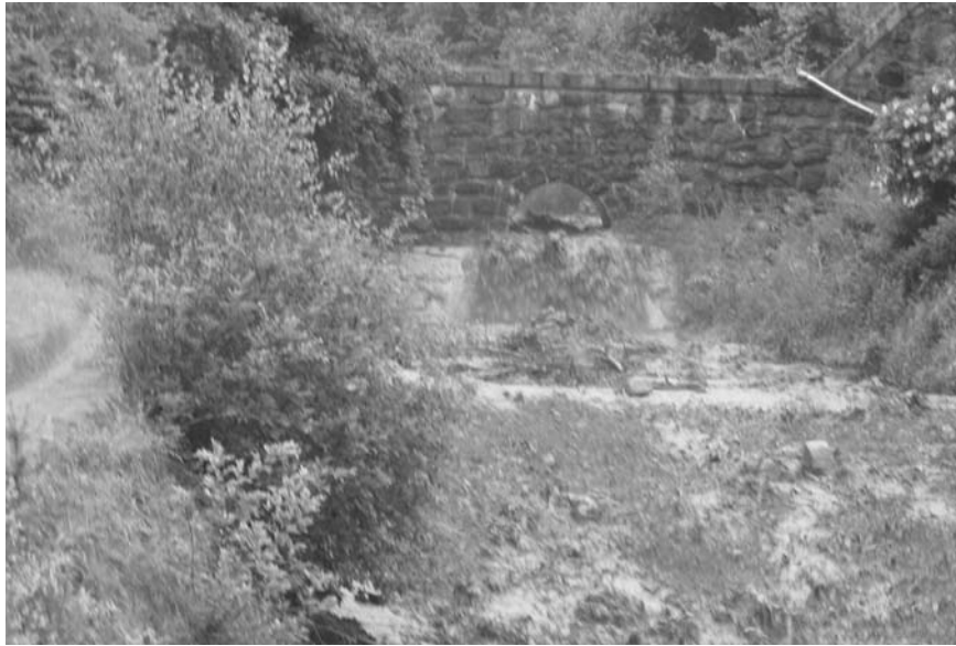
Der Leonhardsbach riss Schotter und größere Steine mit sich
