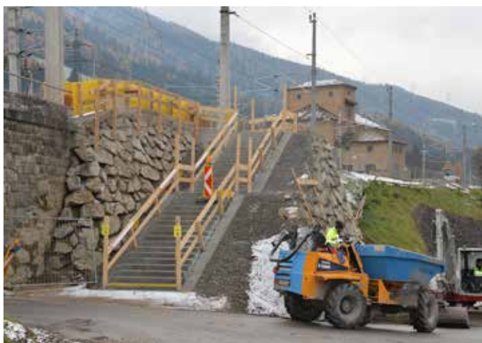
Die neue Treppe, über welche die Bahnkunden zu den beim Bahnsteig 2 ein-fahrenden Zügen gelangen werden.
