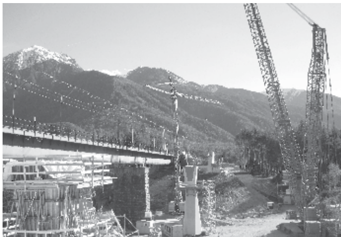
Eine Mega-Baustelle betreibt die ÖBB derzeit bei der Ötztaler Achbrücke. Sie wird bis August erneuert. Foto: gem
