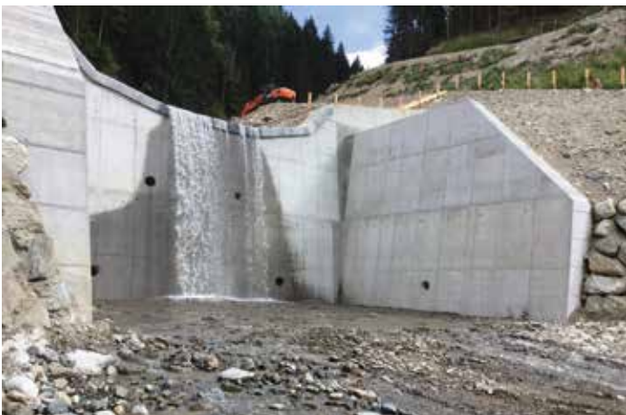
Im Auffangbecken sorgt ein Rückstoßdamm für zusätzliche Sicherheit.
