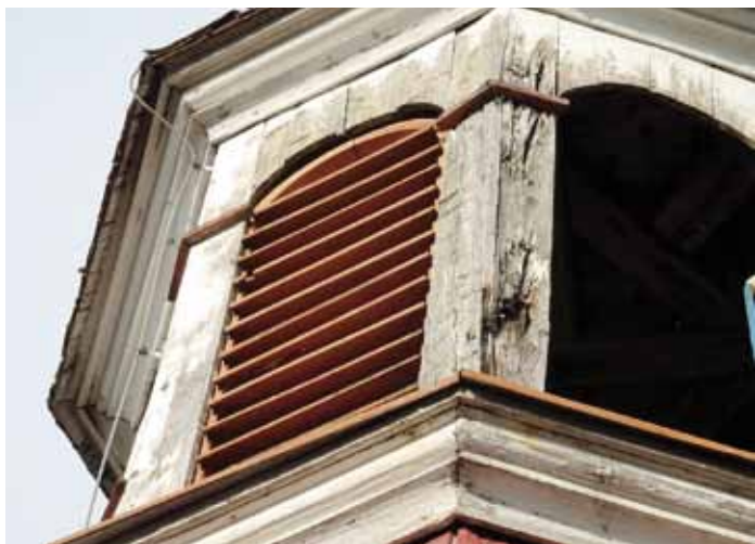
Der renovierungsbedürftige Kirchturm.
